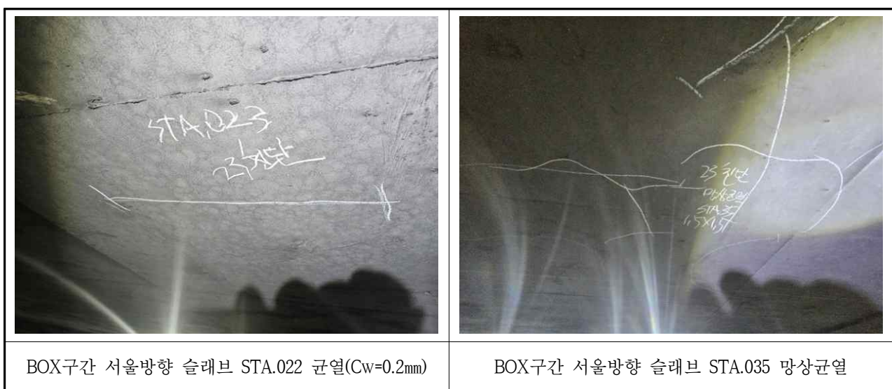
【사진 3.3.1】 BOX구간 외관조사 결과(균열)
