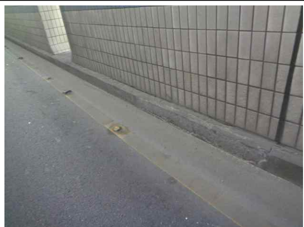
BOX구간 서울방향 연석 STA.470~490 표면박리
