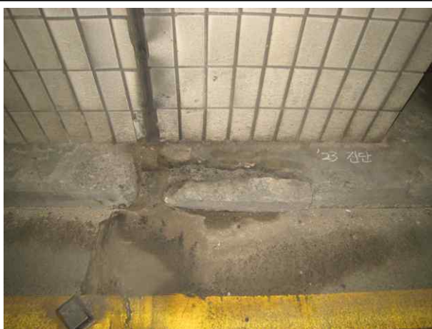
BOX구간 서울방향 연석 STA.290 파손
